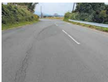
県道神川・内之浦線の道路段差箇所
