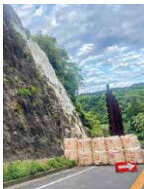
令和8年5月現在の崩落現場
