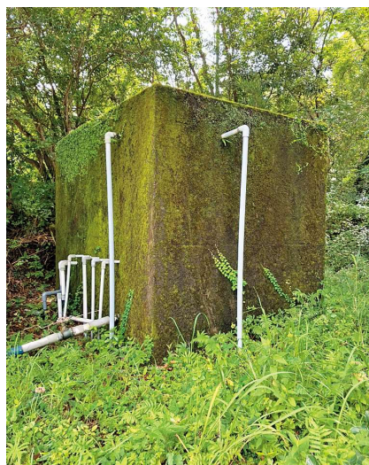
自治会水道タンク
