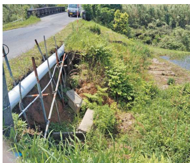
立神橋 田んぼ崩落現場
