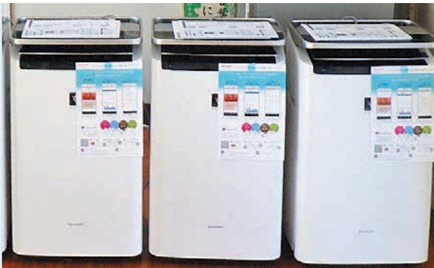
町内小中学校に設置された空気清浄機
