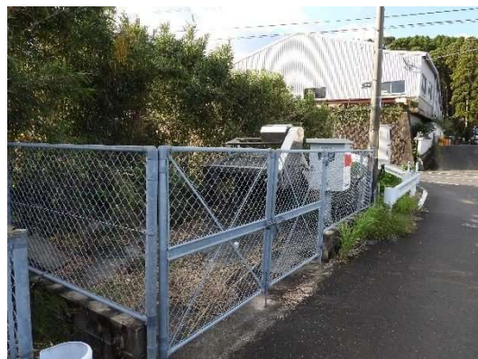
両根占用水路除塵機（馬場地域）
