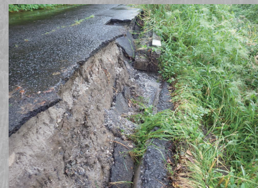
▲ 昨年9月24日の大雨で路肩が崩れた町道
