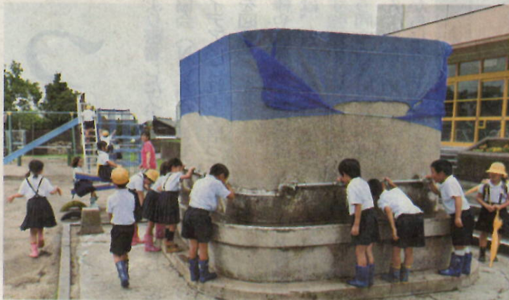
壊れた屋根が撤去された現在の水飲み場 ＝錦江町の大根占小学校
