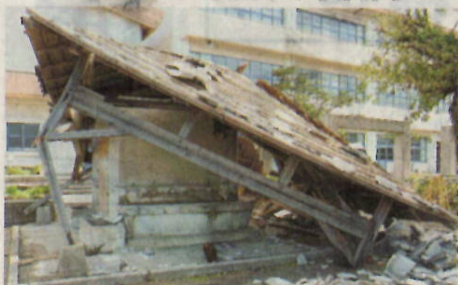
台風16号で壊れた屋根＝2016年9月20日（大根占小学校提供）
