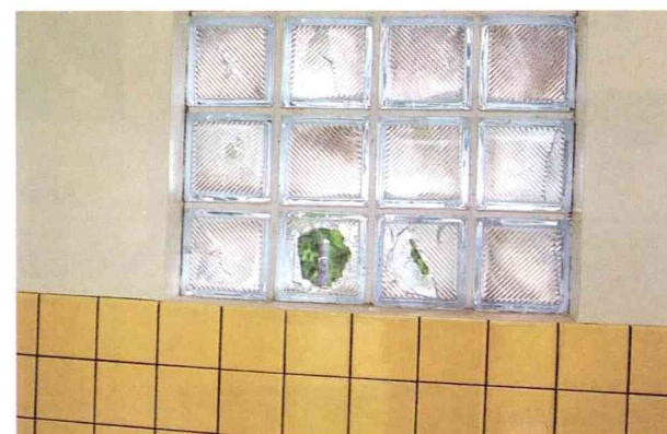
なぜ!?破損したままの公園内のトイレ
