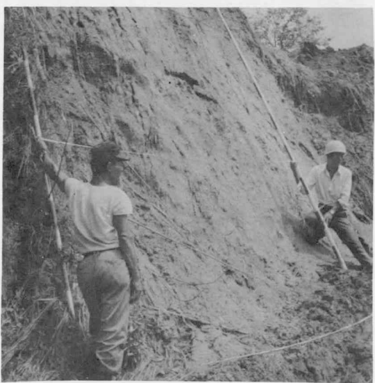
災害の調査も大変（猪鹿倉線）
