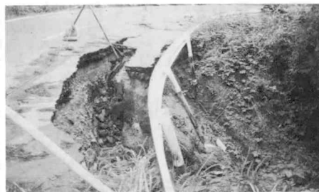
亀裂ができた神川・内之浦線(大久保入口附近)
