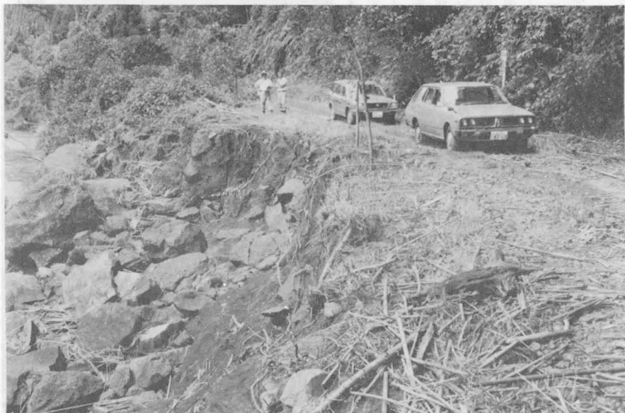
増水により路肩も欠壊
